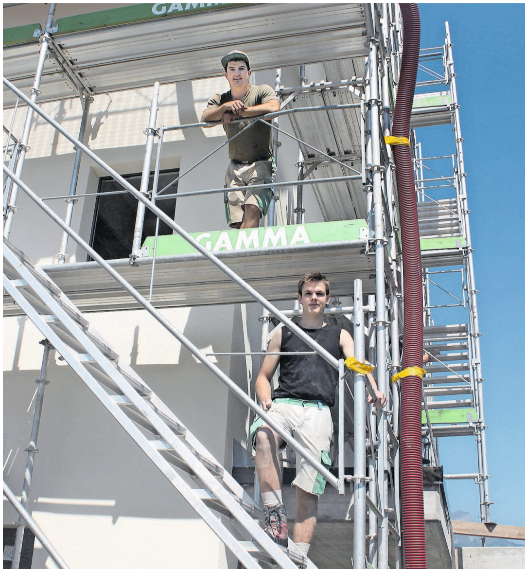
Luca Gisler (2003, oben) und Luca Gisler (2004) auf dem Gerüst der Lehrlingsbaustelle an der Giessenstrasse 1 in Altdorf. Bild: Markus Zwysig (Altdorf, 22. Juli 2022)
